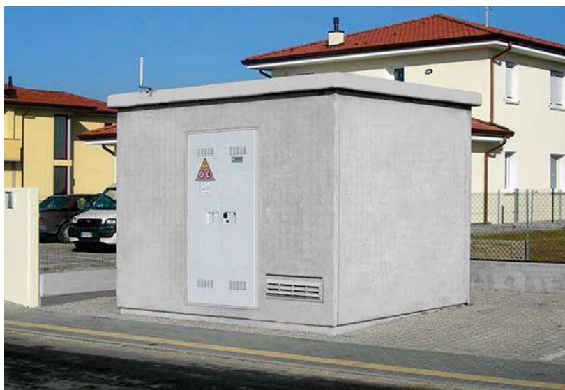
Figura 27 - Cabina elettrica di distribuzione
